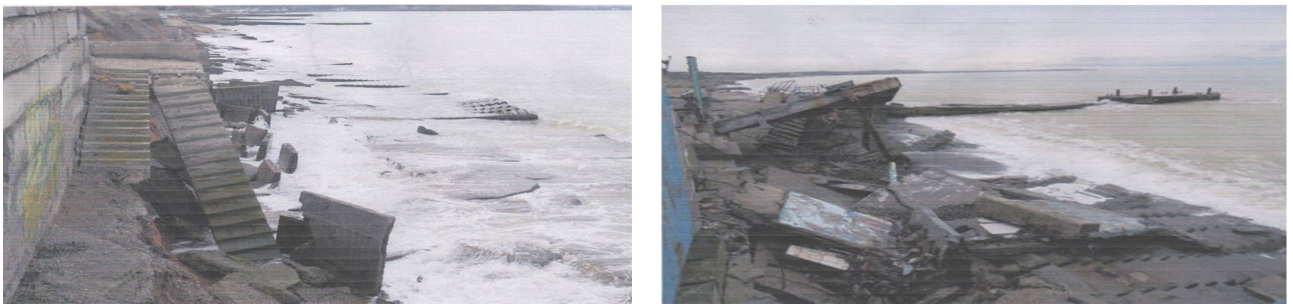
Рис. 2. Состояние берегозащитных сооружений ЮБК, Крым
